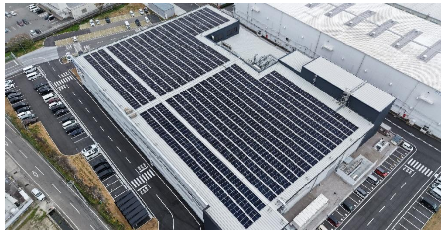
大塚包装 藍住工場 屋上に設置されたソーラーパネル
